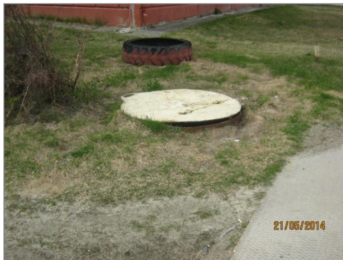
Рисунок 1.8 Канализационные колодцы с неплотностями корпуса.
