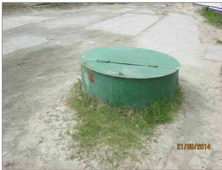
Рисунок 1.5 Колодцы хозяйственной канализации п.Сентябрьский.
