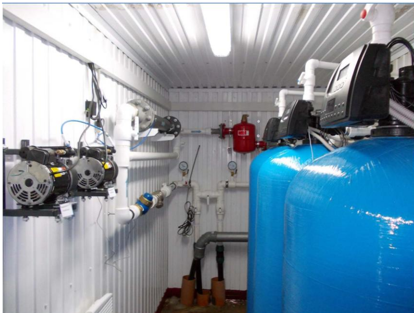
Рисунок 6.1 – Модульная станция обезжелезивания
