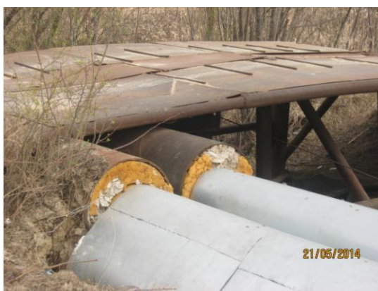
Рисунок 1.4 - Теплоизоляция сетей наземной прокладки сетей водоснабжения
