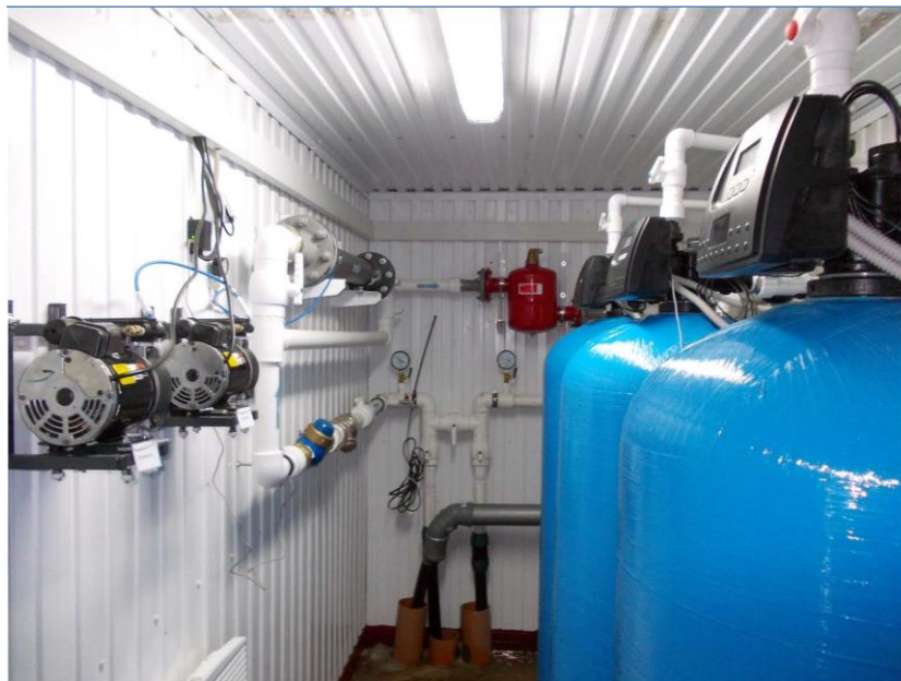
Рисунок 6.1 – Модульная станция обезжелезивания
