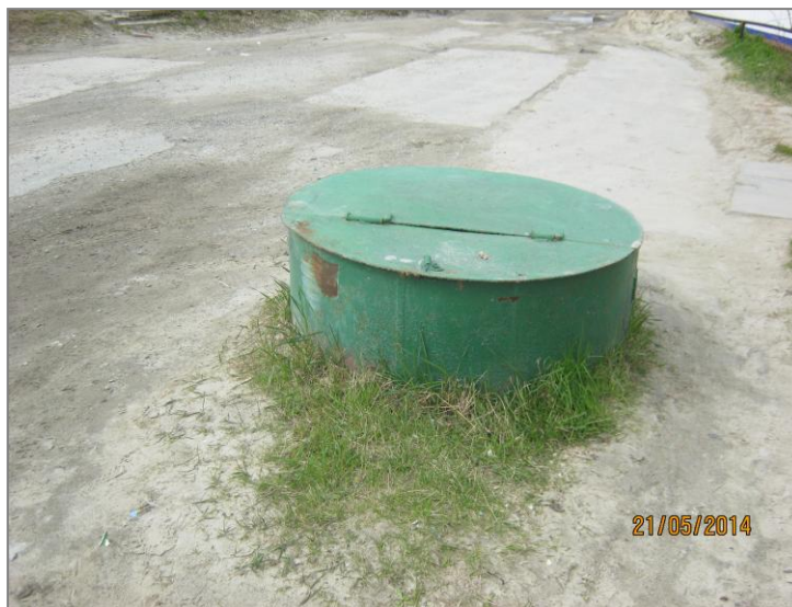
Рисунок 1.5 Колодцы хозяйственной канализации п.Сентябрьский.
