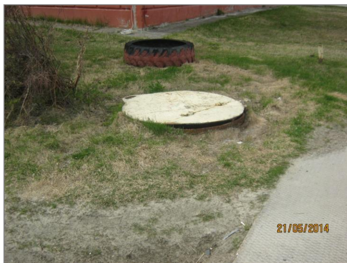
Рисунок 1.8 Канализационные колодцы с неплотностями корпуса.
