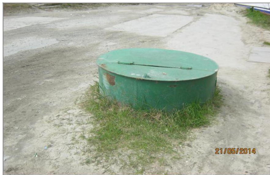
Рисунок 1.5 Колодцы хозяйственной канализации п.Сентябрьский.
