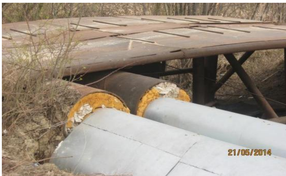
Рисунок 1.4 – Теплоизоляция сетей наземной прокладки сетей водоснабжения
