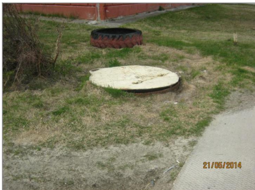
Рисунок 1.8 Канализационные колодцы с неплотностями корпуса.
